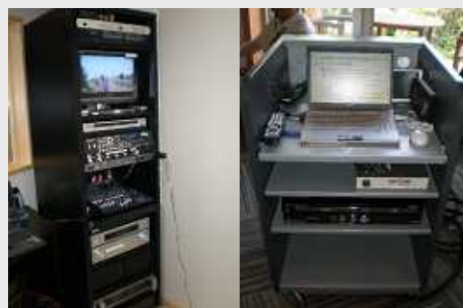
コントロールルーム
