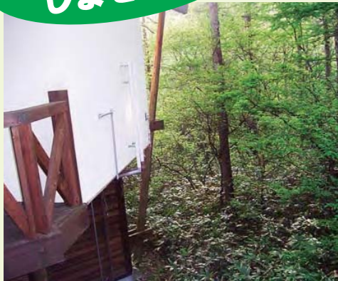
建物周りは笹で覆われ雑木が茂り日陰となっていました。湿気がこもり当然、害虫等の好む環境でした。
